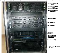
Slika br.6 Fizički izgled rack ormara Primarnog data centra
