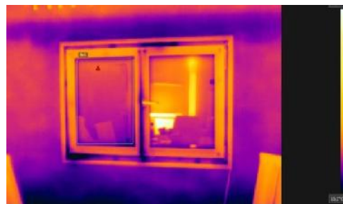
Slika 2. Termovizijska slika prozora snimano iznutra – objekt I
