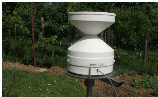
Slika 3. e+ RAIN Automatski pluviograf instaliran u Ripnju -Draženovac
