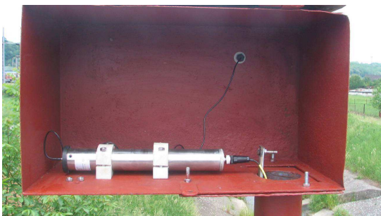
Slika 6. Detalj merne i transimione instalacije na limnometrijskoj stanici „Resnik“
